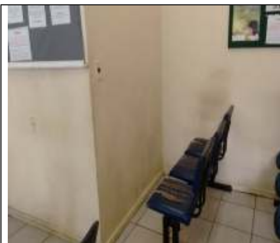
Foto 1 - Sala de recepção: Paredes sujas e bancos rasgados.
