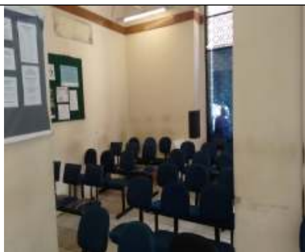
Foto 2 - Sala de recepção: Paredes sujas e bancos rasgados.
