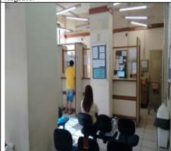
Foto 3 - Instalações improvisadas das luminárias.
