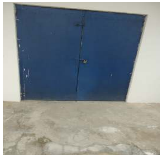
Foto 2 da entrada da sala principal para armazenagem de medicamentos CEAF na UNICAT em Natal (1ª quinzena de setembro de 2014)- Detalhe: ausência de vedações para entrada de pequenos animais e água, principalmente no piso.
