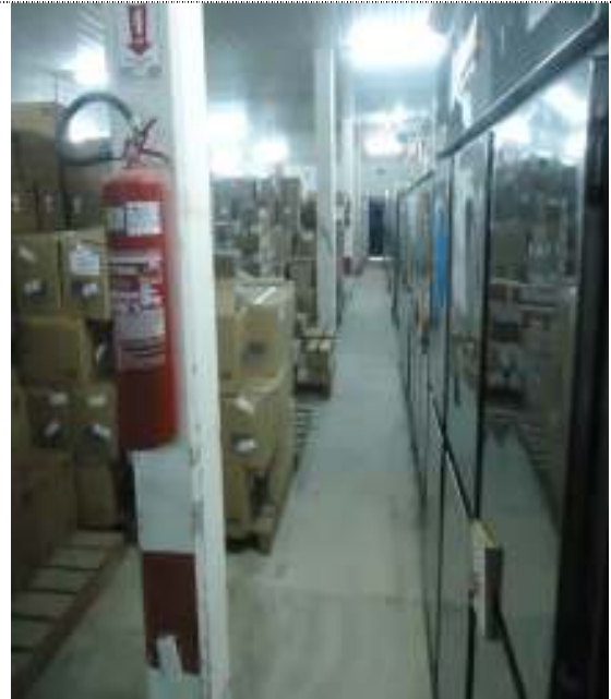
Foto 6 dos refrigeradores com medicamentos CEAF na UNICAT em Natal (1ª quinzena de setembro de 2014). Detalhe: extintores de CO2 e água, próximos aos equipamentos.
