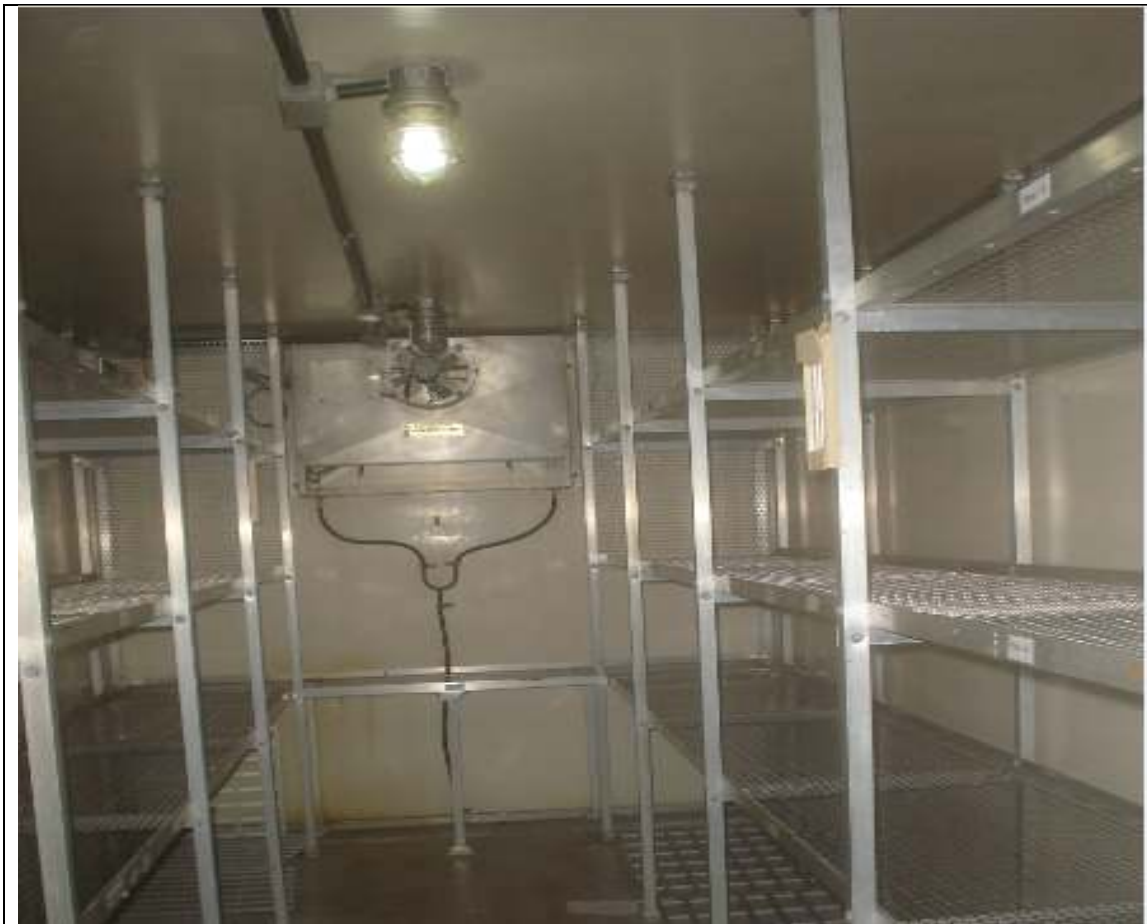
Detalhe da câmara fria vazia
