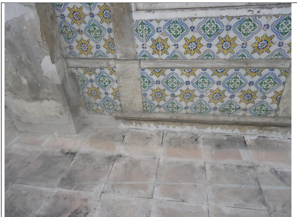
FOTO 01: Azulejos da parede lateral na Rua Real da Torre. Alguns azulejos apresentam sujidades em consequência da ação do tempo e do descuido quando das obras do Túnel da Abolição, a alguns metros desta parede.
