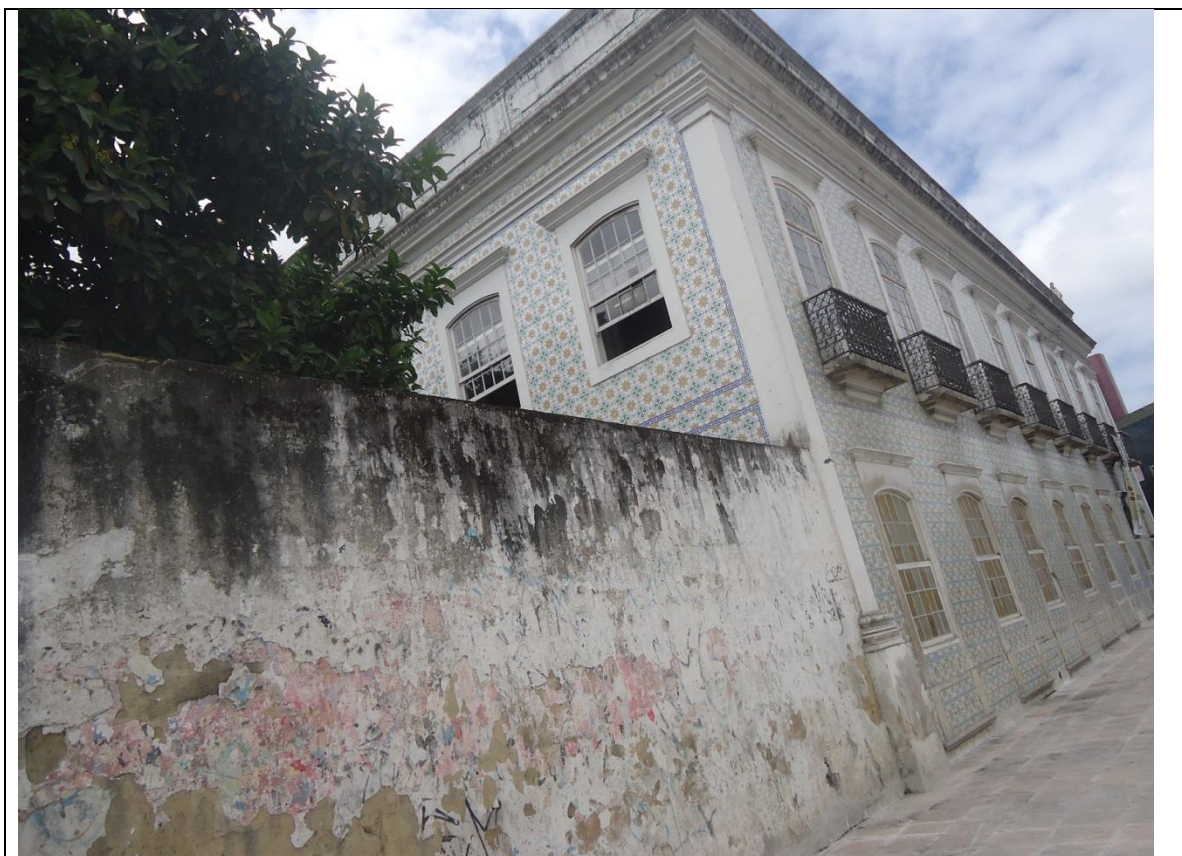
FOTO 03: Janelas do primeiro andar (fundos) com perda parcial das vidraças. As varandas do primeiro andar (lateral da Real da Torre) apresentam-se com ferrugem.
