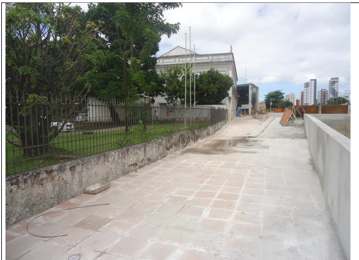
FOTO 02: Vista do passeio lateral do Sobrado (Rua Real da Torre). Mostram-se as novas pedras do passeio. Não foi respeitado o caimento natural existente. Havia uma declividade do piso da Rua Benfica em direção ao fundo terreno do Sobrado Grande da Madalena.
